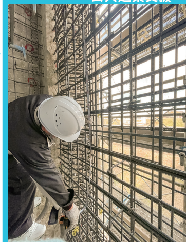
井手町合藪ポンプ場 (井手町内)
